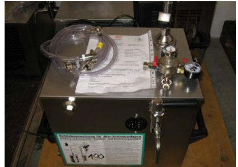
Abb. 9 Beispielhafte nicht verwendungsfertige Getränkeschankanlage
