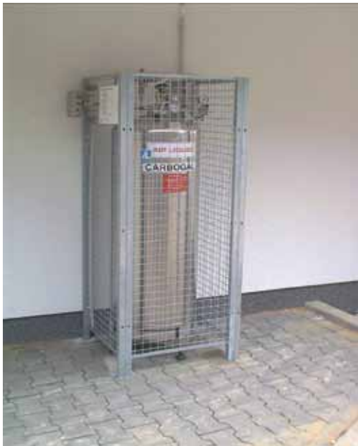
Abb. 5: Beispielhafte Aufstellung eines (stationären) Druckbehälters
