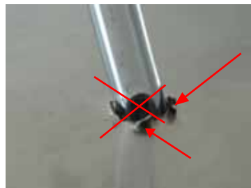
Abb. 13: Verbotene Verlegung (Bohrung nicht entgratet, fehlende Tülle oder dgl.)
